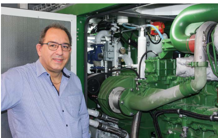
Thomas Foh, Handwerksmeister und Experte für Wärmeversorgungsanlagen der Stadtwerke Dachau
